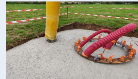
Fondation tracker solaire
